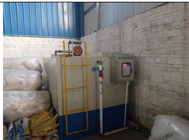
生活污水一体化污水设施
