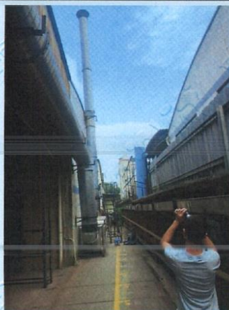
生产废气排放口 (DA001) (2)
