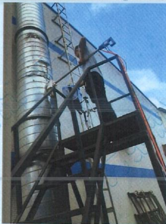
生产废气排放口 (DA001) (1)
